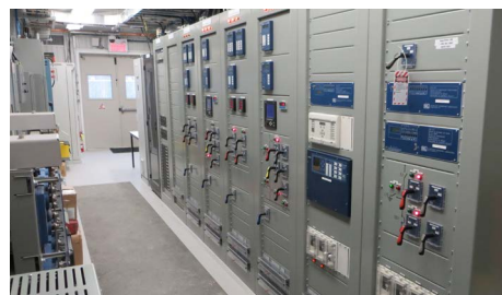
Panneaux de contrôle du bâtiment de commande
